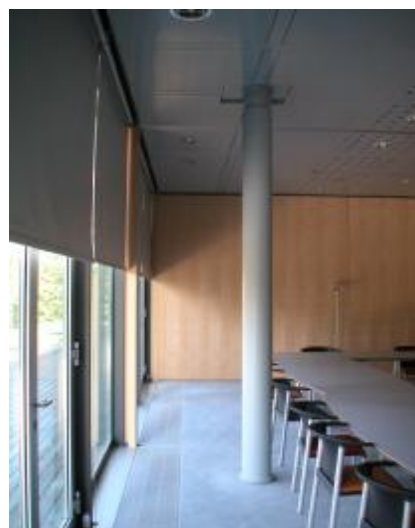
Seminarraum mit Konvektor und Kühldecke
